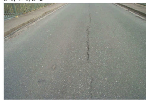
BELAG MEHRFACH GERISSEN
