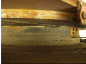
RISSE IM LAGER
